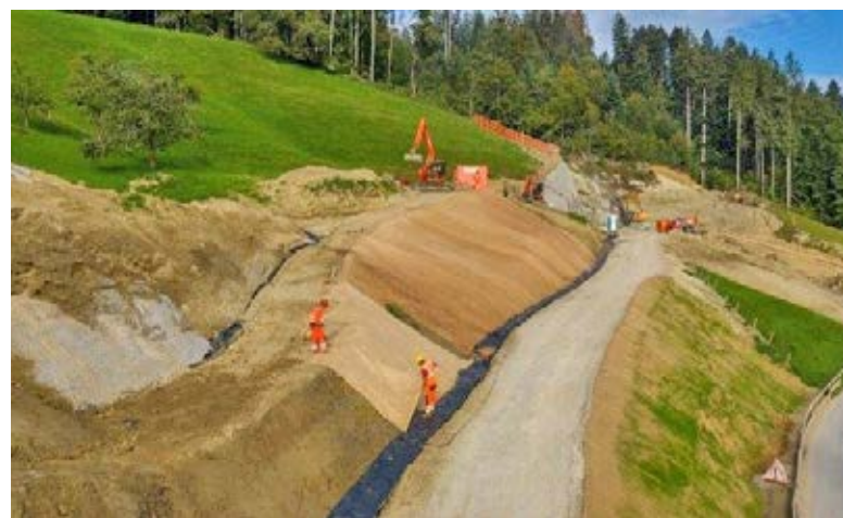
Abb. 7: Verlegte Holzwollevliese zur Böschungssicherung in der Ostschweiz. Fig. 7 : Pose de la natte en laine de bois pour la consolidation de pentes en Suisse orientale.
