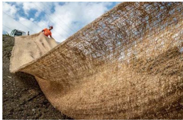
Abb. 3: Verlegen der Holzwollevliese ist Handarbeit. Fig. 3 : La pose d'une natte en laine de bois est un travail manuel.
